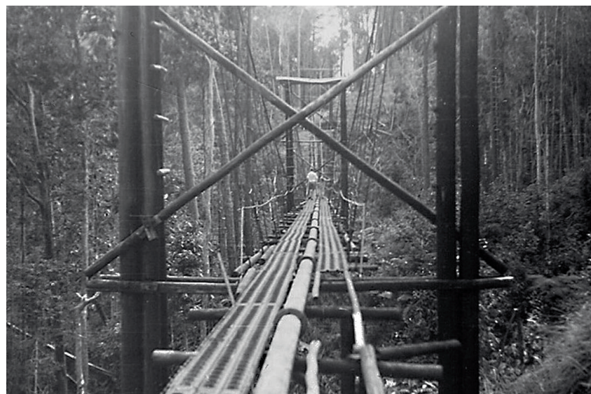
8 Oorspronkelijk door de Amerikanen aangelegd buizenstelsel om drinkwater naar Hollandia te vervoeren.
